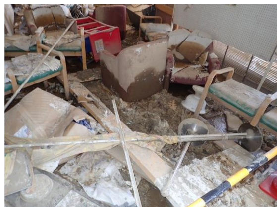
床に落下したロックウール吸音天井板
