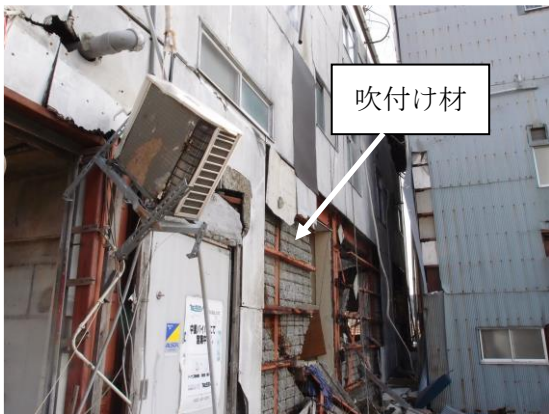
吹付け材が露出している例
