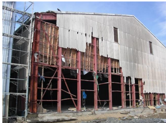
津波により破損、落下したスレート波板
