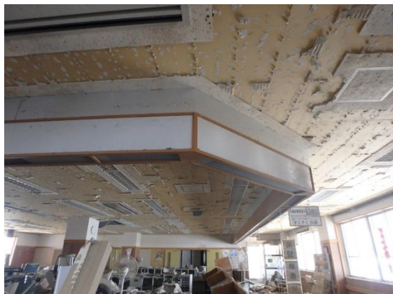
水没後に落下したロックウール吸音天井板
