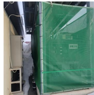
導入した非常用自家発電機
