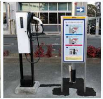
E V用充電器 〔福岡地方合同庁舎〕
