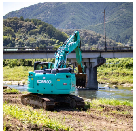
■きめ細やかな施工のためには、事前に行う測量も高精度であることが重要
