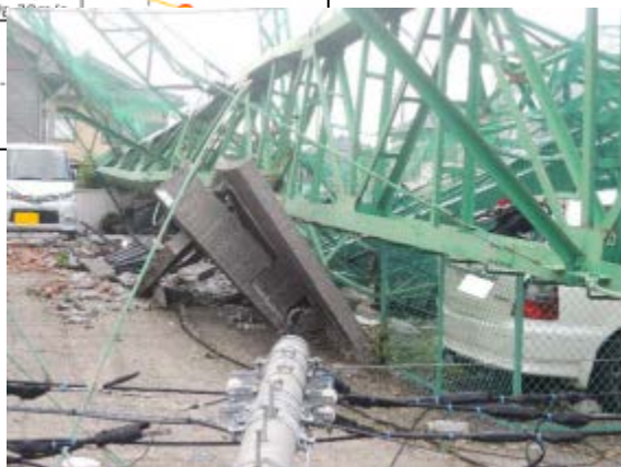
鉄柱決壊による被害(千葉県)
