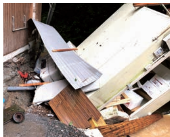
被災した設備
